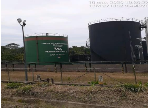
FOTOGRAFIA N° 7: Instalacion Petrolera Campo Payamino
