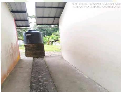
FOTOGRAFIA N° 11: Tanque de agua de la Escuela Pedro Alvarado
