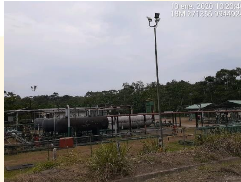
FOTOGRAFIA N° 8: Instalacion Petrolera Campo Payamino
